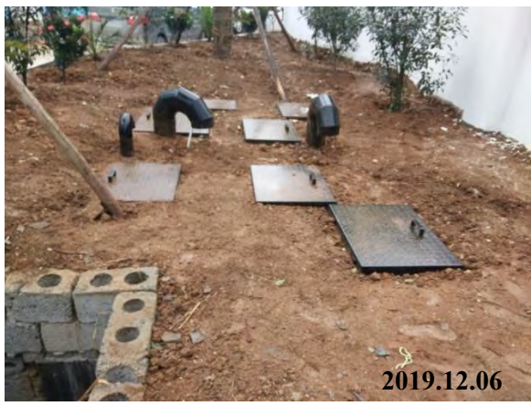
院内污水处理站
