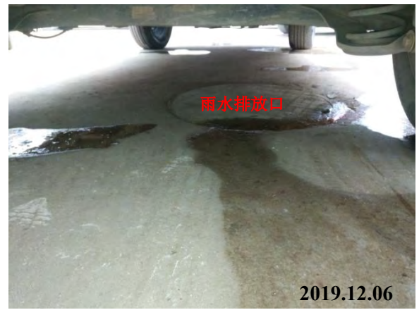
雨水总排放口
